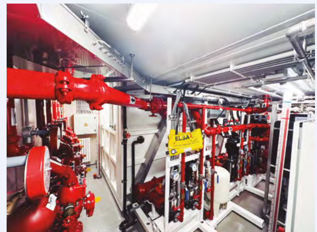
Casa de bombas do Sistema de Controle de Avarias
